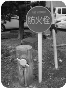
防火栓の新しいフタ
