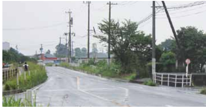
LED防犯灯新設工事箇所 LED灯(40W級)40基 (県道六嘉秋津新町線沿下六嘉入口より上六嘉迄の間)
