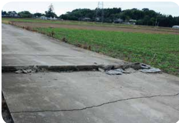
損傷した井寺の道路
