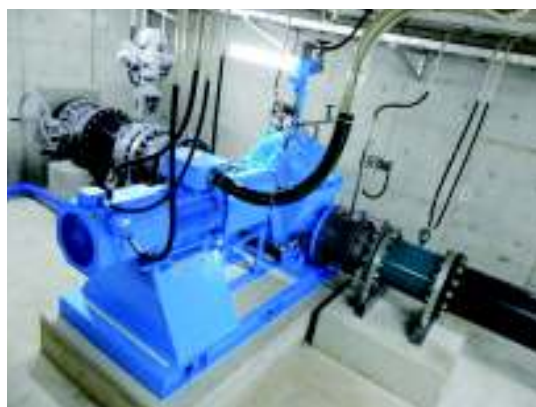
小水力発電（戸島送水場）
