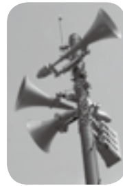
デジタル防災行政無線の屋外スピーカー
