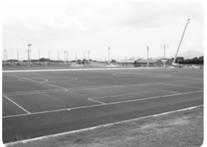
県フットボールセンターのサッカー場。道を挟んで奥は町総合運動公園西エリア＝8月23日、一部建物や外構はなお工事が進んでいました
