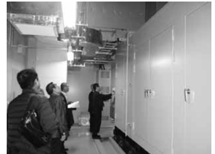
自家発電設備
