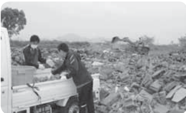
↑浮島水辺公園北側の災害ごみ置き場 (4月18日)
